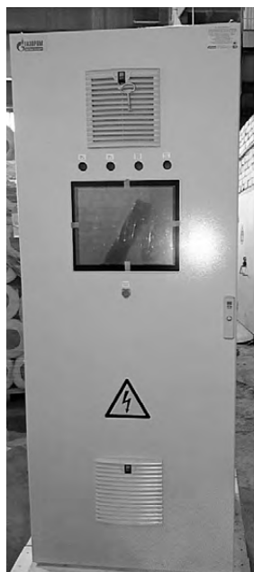
Шкаф САУ левый
