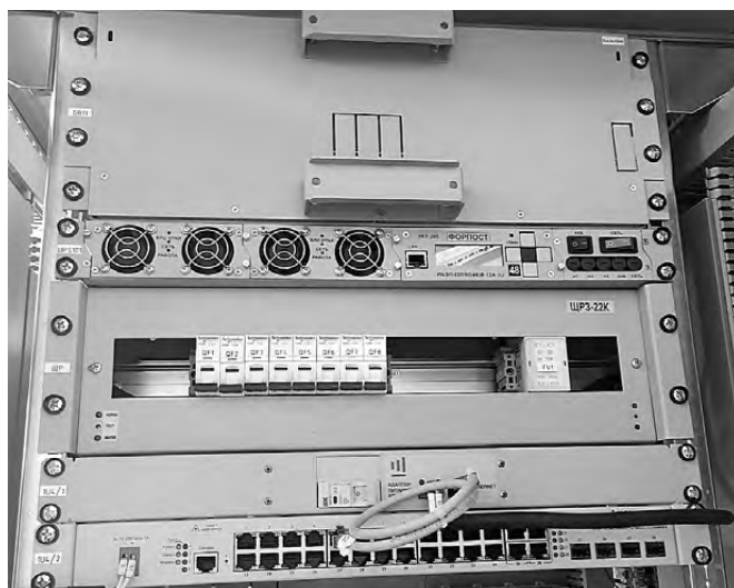
Рис 7. Оборудование связи, устанавливаемое в шкафу САУ МКУ
