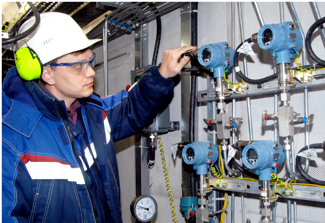
Внутри модульной компрессорной установки (МКУ) на кустовой площадке ГП-6
