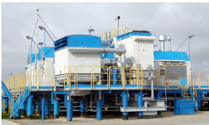
МКУ обеспечивает транспортировку газа от куста до ДКС ГП-6
