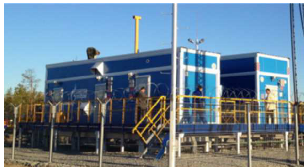
Рисунок 2. Общий вид мобильной компрессорной установки на базе винтового компрессора «GEA Grasso»
